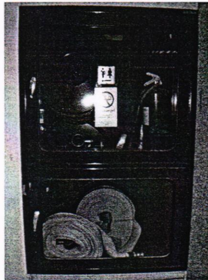
รูป3 ตู้ดับเพลิง
