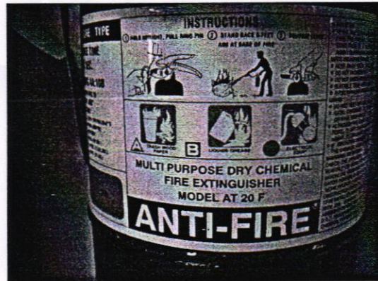
รูป4 ถังดับเพลิง
